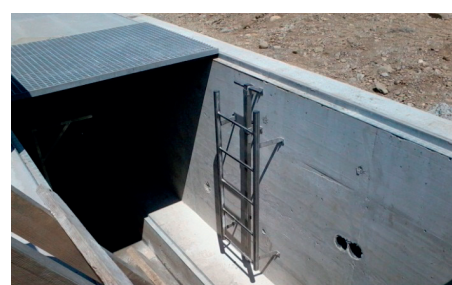
Čistilna naprava – merilno mesto
