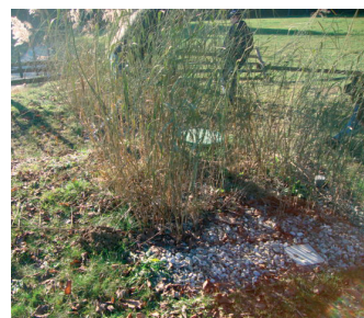
Rastlinska čistilna naprava za 4 osebe.
